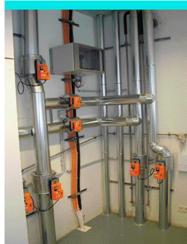
Bild 7: Optimierung der Verfügbarkeit: Redundante Strangumschaltung der Kälteversorgung für den Serverraum mit automatischer Störumschaltung. Weitere Besonderheit: Die Abwärme der Kältemaschinen wird zur Beheizung des Neubaus genutzt. Auf einen separaten Wärmereizerger konnte verzichtet werden.
